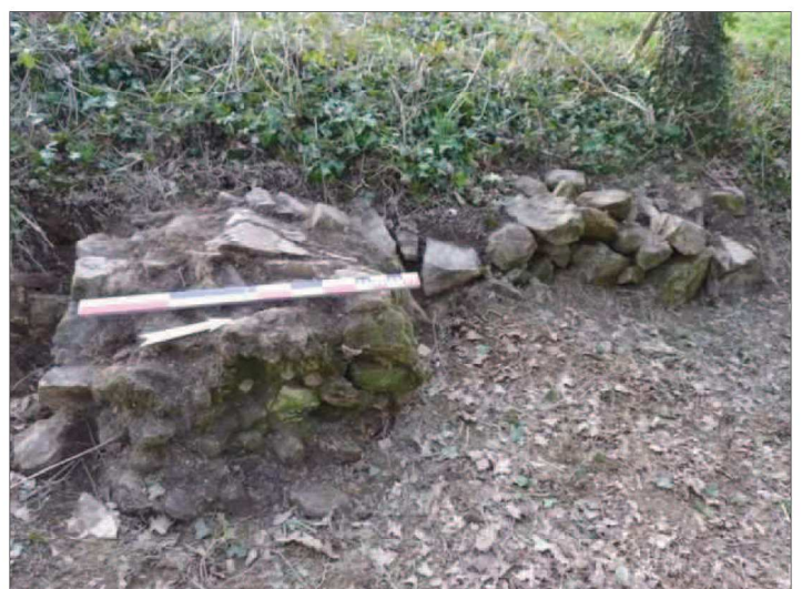
Photo 44 : Reste de parement à l'ouest du fossé (à droite) et élément de la tour roulé dans le fossé (à gauche)
