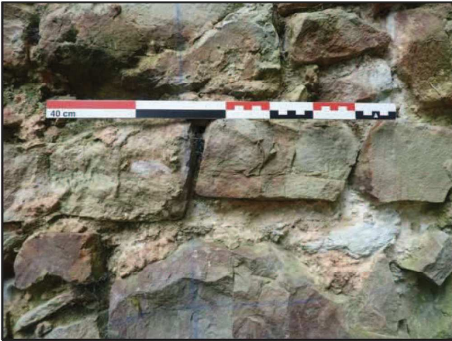
Photo 28 : Appareillage en grès et mortier ayant chauffé dans le parement intérieur de la tour
